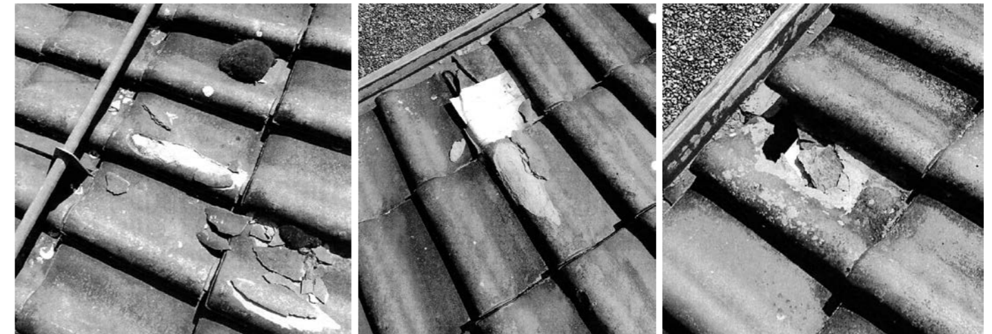
defekte Ziegel Mehrzwecktrakt Schulhaus Walkringen
