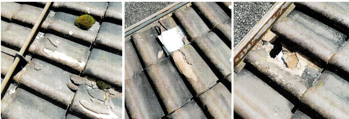
defekte Ziegel Mehrzwecktrakt Schulhaus Walkringen
